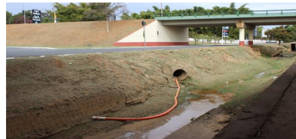
Figura 2.38 - Córrego Invernada (captação emergencial) - Valinhos. Fonte: Arquivo Agência das Bacias PCJ.
