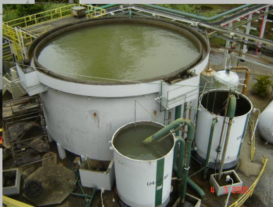
ETA 1 – capacidade 200 m 3 /h
