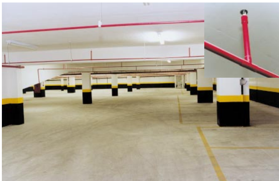
Um dos pisos de garagem. Sprinkler (detalhe) integra sistema de combate a incêndios.
